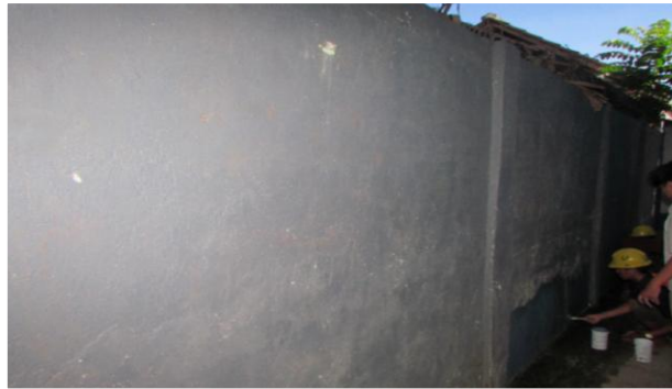
Gambar 1. Kondisi Fisik Dinding Sekolah UPT SD Negeri Ngadirenggo 01 Sebelum Implemetasi Program.
